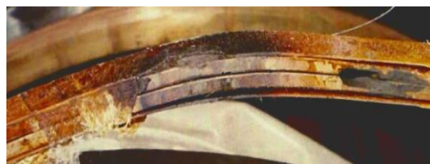
Витковое замыкание с выплавлением меди пазовой части витка обмотки и меди на дуговом участке лобовых частей
