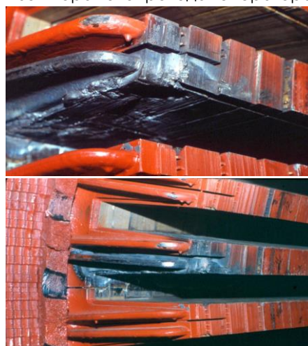
Характер повреждения статора при однофазном замыкании
