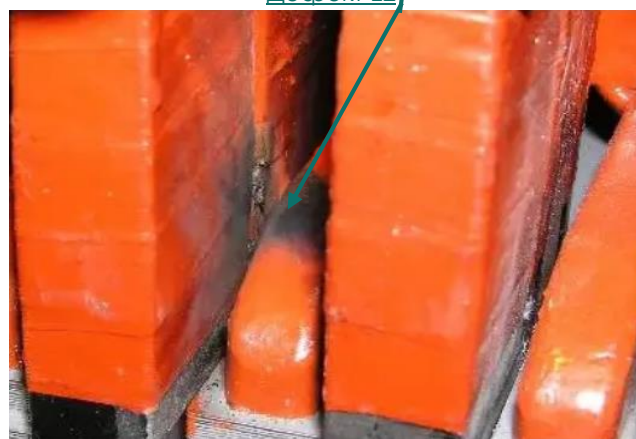
Дефект E2 – ЧР в лобовых частях обмотки статора
