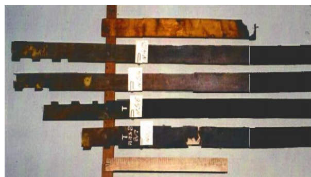
Перегрев витковой изоляции лобовых частей обмотки ротора
