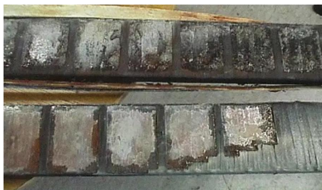
Дефект S3 – истирание изоляции обмотки статора, защищающей от короны в пазу статора
